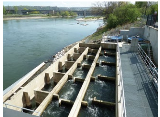
Fischaufstiegsanlage an der Staustufe Koblenz in der Mosel Quelle: Stephan Naumann
